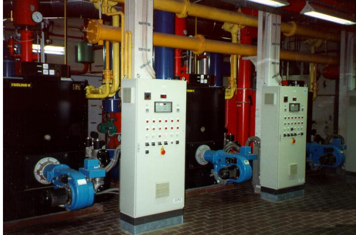
Bestehende Gaskesselanlage, Nutzleistung je 1.000 kW
